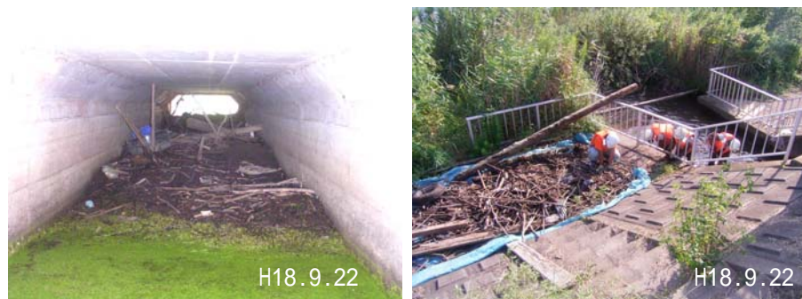
写真.2 消波工から流出した内蔵粗朶が河川管理構造物(樋管)に大量に流入(平成18年9月)
