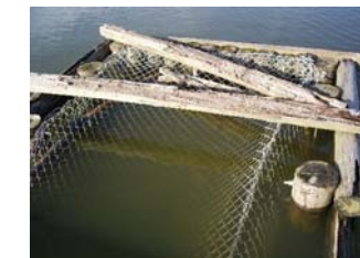
境2 縦梁破損状況 H18.10.26撮影
