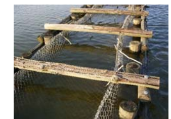
境3 縦梁腐食状況 H18.10.26撮影
