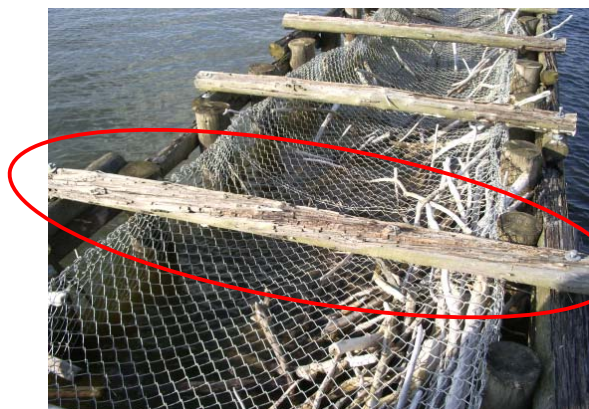
縦木が腐蝕している
