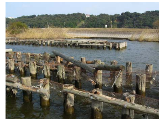
杭の損傷状況（3）
