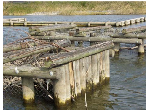
粗朶工の端部が腐食している
