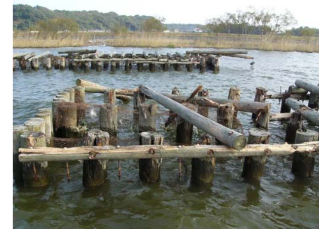
杭の損傷状況（2）
