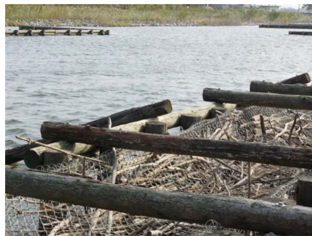
粗朶の押え杭が損傷している
