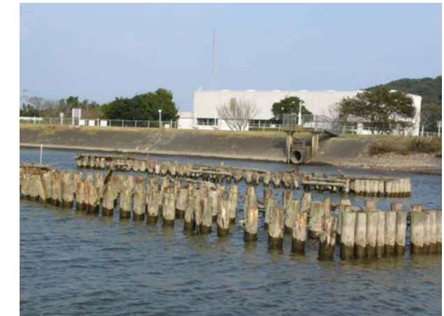
粗朶の押え杭が全て流出している
