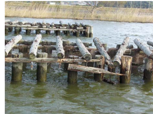
杭の損傷状況（1）
