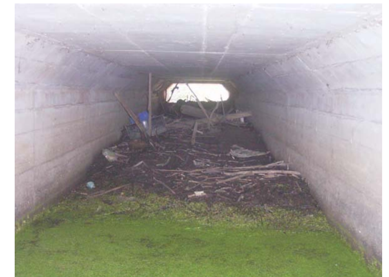
平成18年9月 樋管内部の粗朶流入状況
